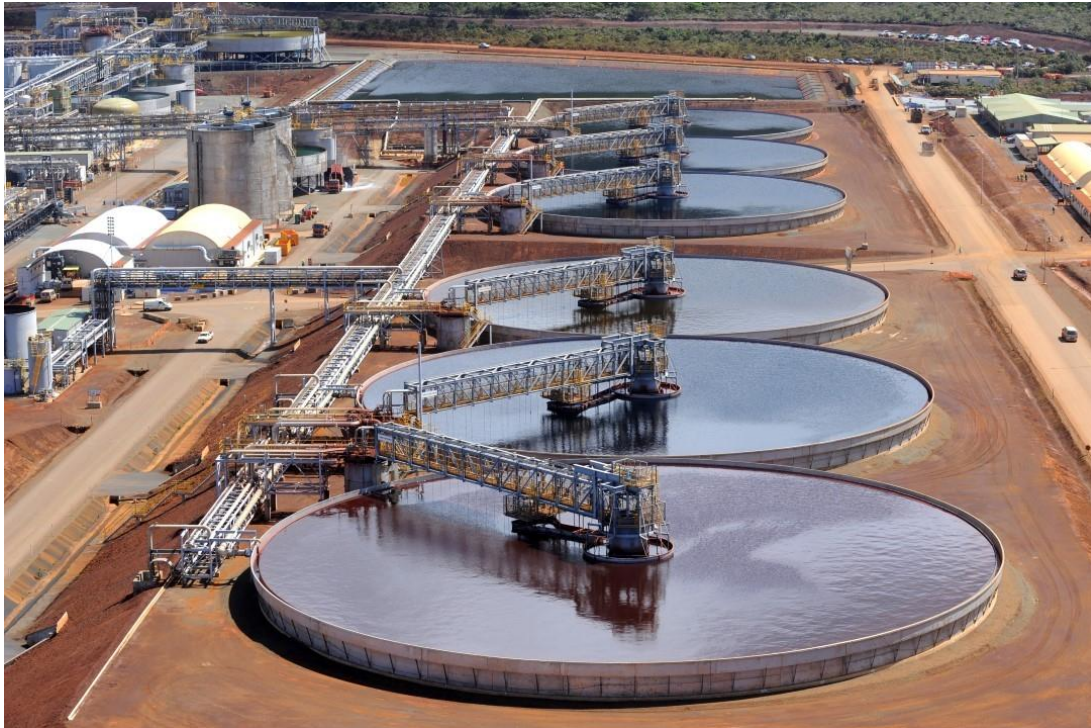
Figure 3 : Vue extérieure des cuves de décantation
