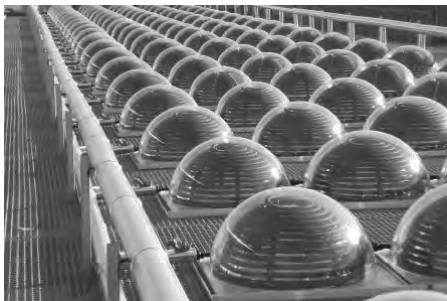
Figure 6 : Capteurs solaires dômes en toiture
