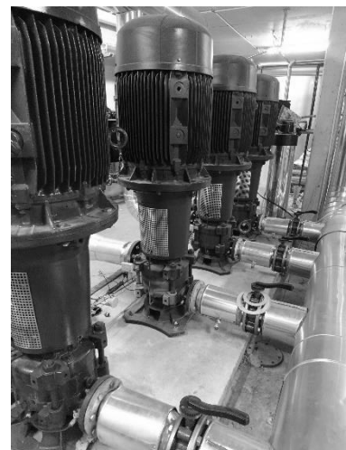
Figure 8 : Pompes réseau ECLA
