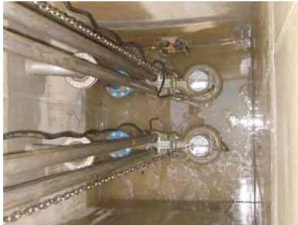
figure 18. Poste de recirculation
