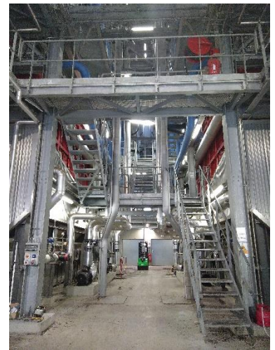
Figure 2 : Chaufferie de Malakoff
